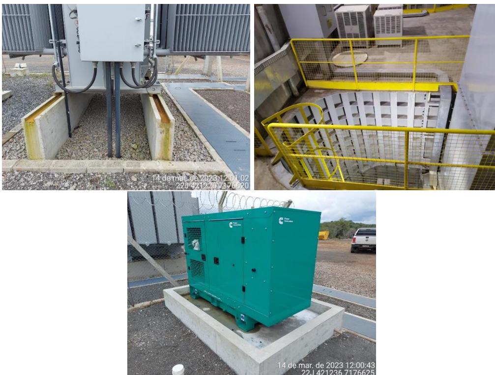
Figura 4: Caixa separadora de óleo e água na subestação e no interior da casa de máquinas e base estanque do gerador diesel.
